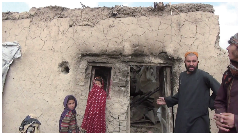
天井が崩落。風雪にさらされながらここで眠る
